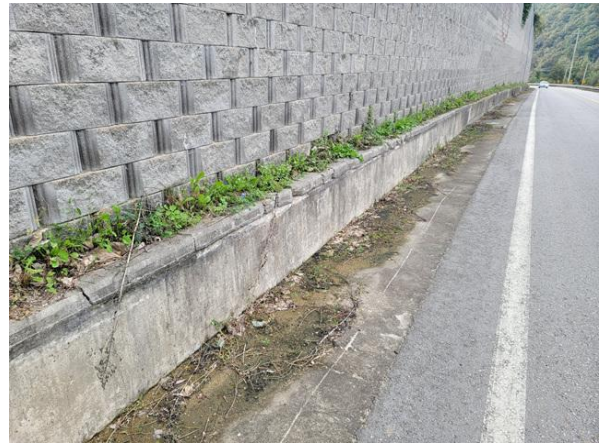
S6 하부 방호벽 파손(0.2x4.0)
