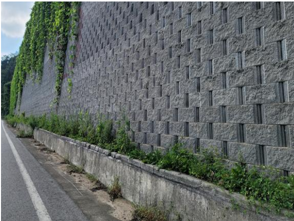
S6 하부 방호벽 파손(0.2x4.0)
